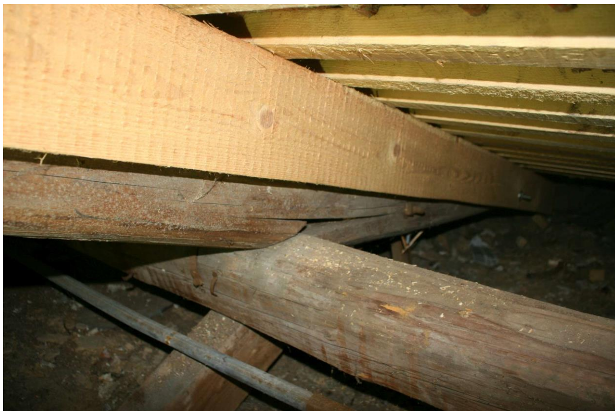
Obr. 2 – Zlomená krokev a oprava základní hambalkové vazby krovu nad sálem
