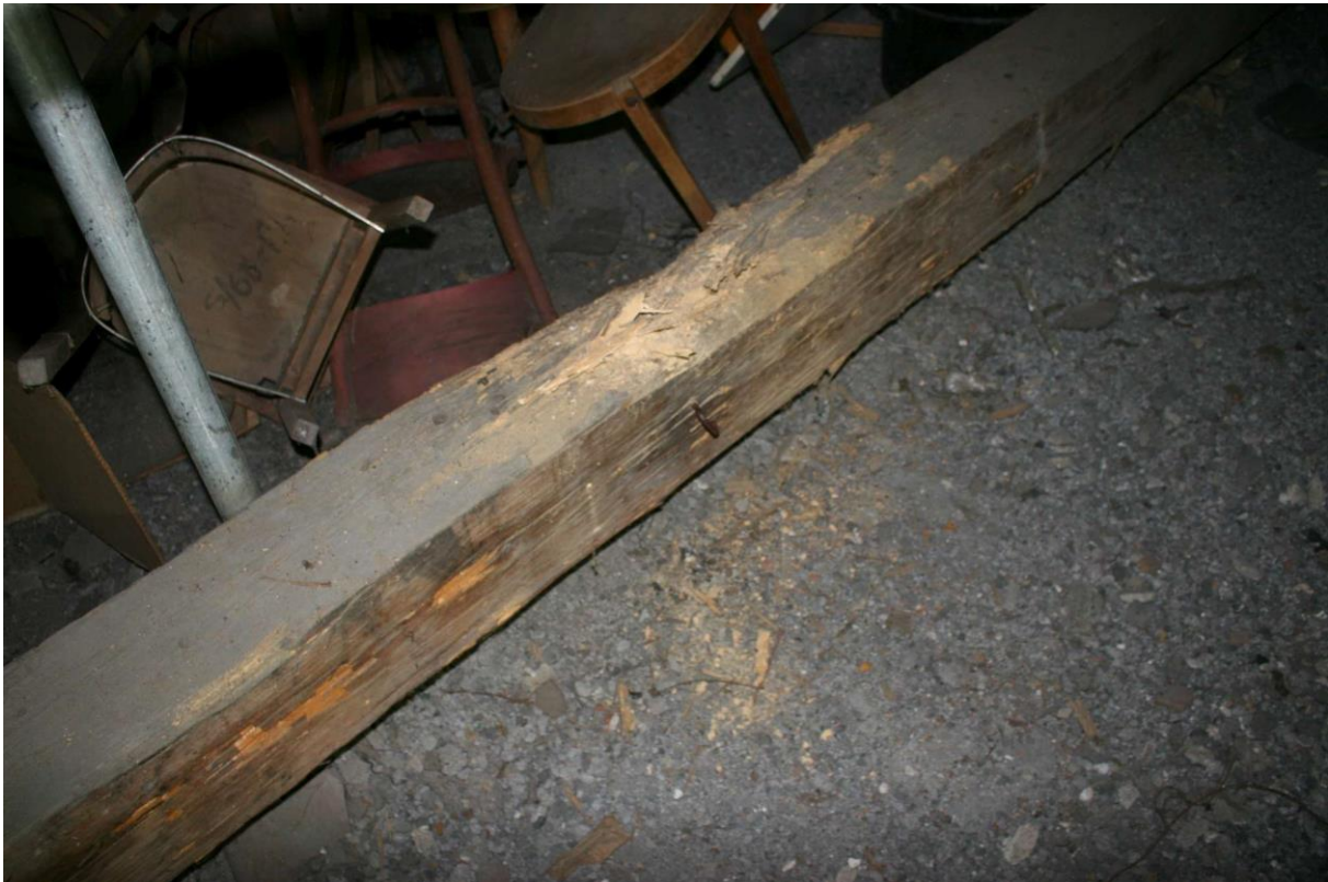
Obr. 1 – Poškození vazného trámu dřevokazným hmyzem
