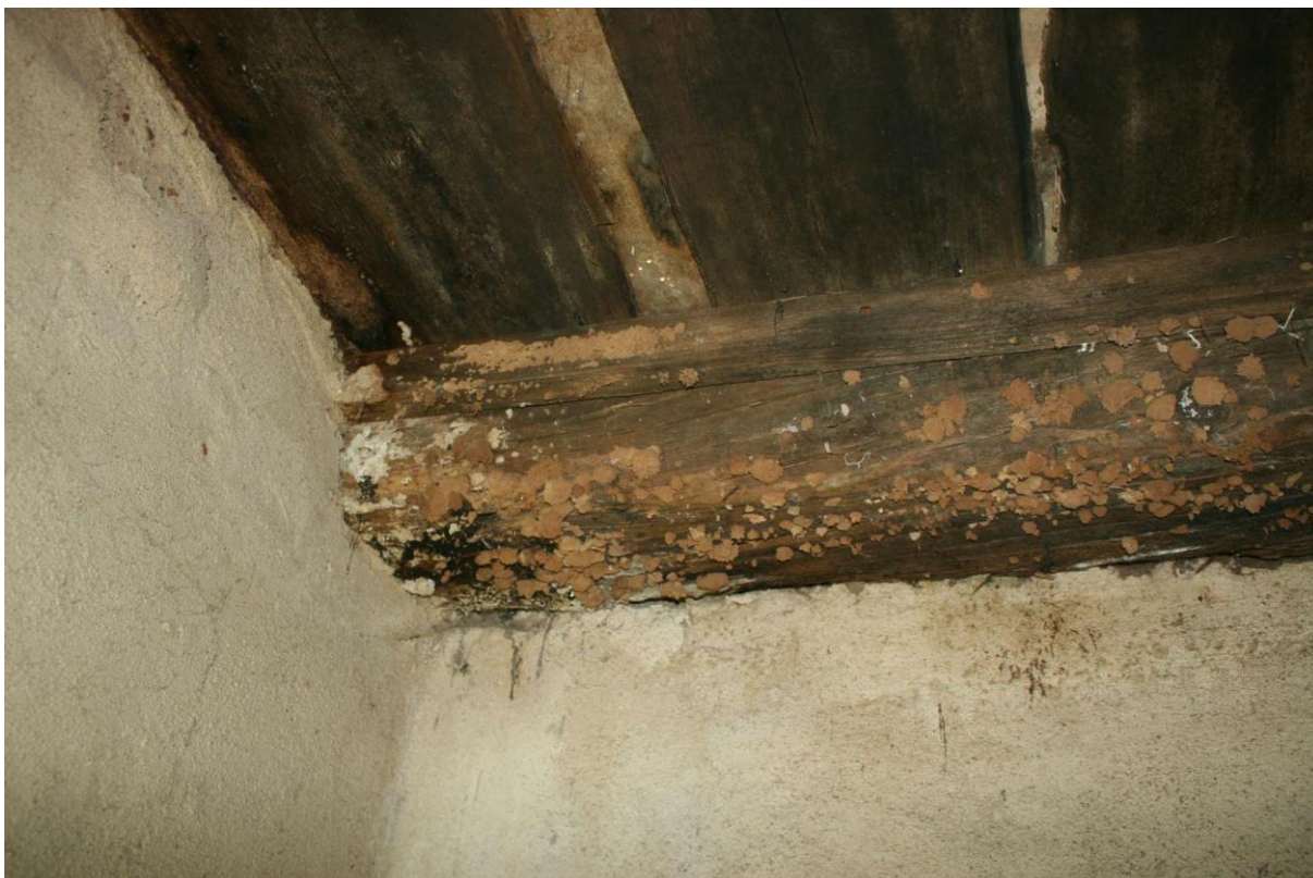
Obr. 6 – Dřevěné trámy pódia jeviště – napadení dřevomorkou domácí
