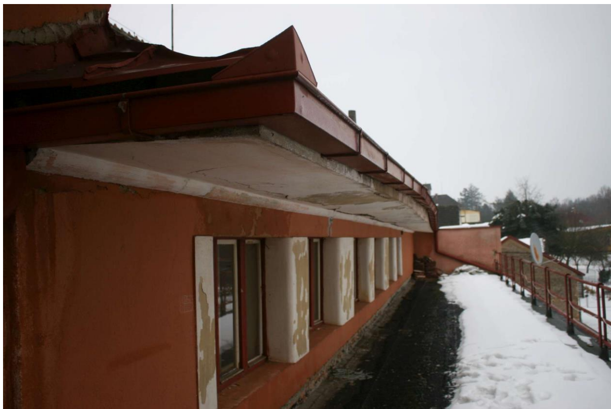
Obr. 3 – Deformace střešní římsy nad jižní fasádou
