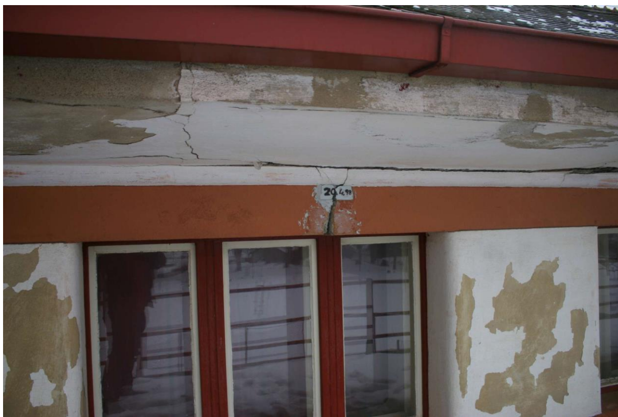
Obr. 4 – Trhliny na zdivu jižní fasády
